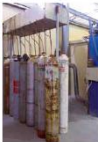
Ξηραντήριο - στεγνωτήριο φιαλών και πυροσβεστήρων που προέρχονται από το μηχάνημα υδραυλικών δοκιμών.
